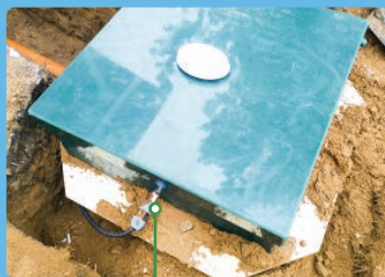
Электрический кабель в гофре
